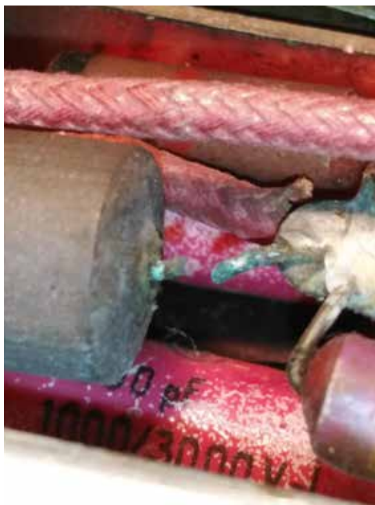
Sl. 23. Prekid priključne žice kondenzatora koji filtrira napon druge rešetke pentode
